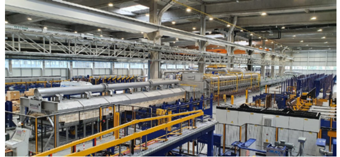
Bild 1: Rollenherdofen für das Normalisieren von Kohlenstoffstahlrohren
