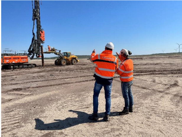
Mit 29 MW (peak) entsteht auf dem Cottbuser Ostsee Deutschlands größte Floating-PV-Anlage. Foto: LEAG
